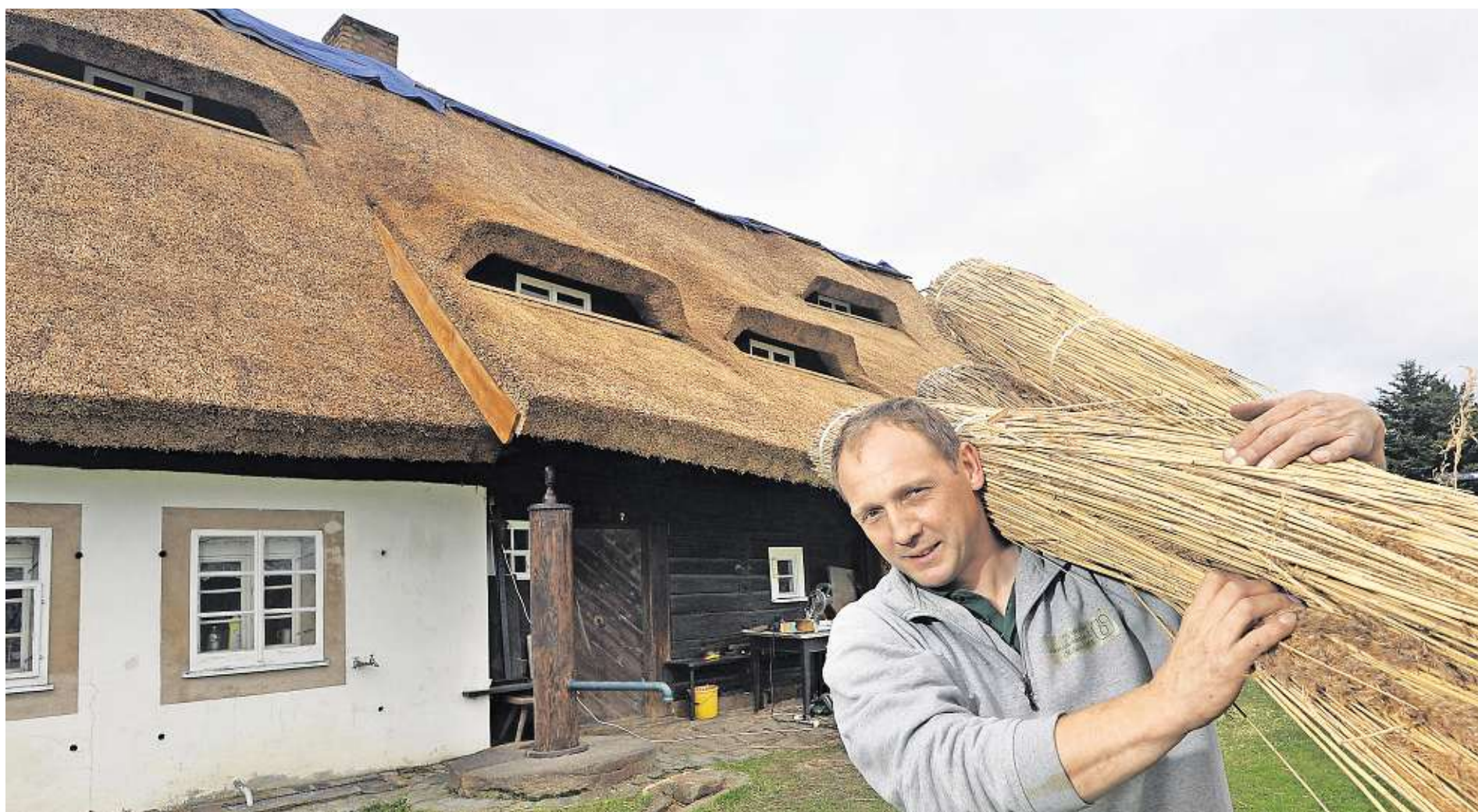
Drei Bündel Reet trägt Marko Dartscht auf der Schulter. Eintausendmal so viele Bündel befestigen er und seine Kollegen von der Firma Weichert Reetbedachungen aus Berlin auf dem Dach des Hauses, das vermutlich das älteste von Sohland ist. Mit Sicherheit ist es aber das Einzige im Ort, das ein Schilfdach hat.
